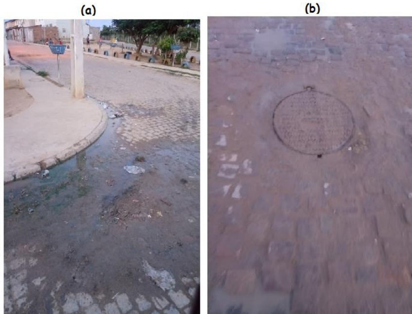
Figura 18 - Loteamento Vila Sul (a) disposição de águas residuárias na rua (b) caixa de inspeção da rede coletora
