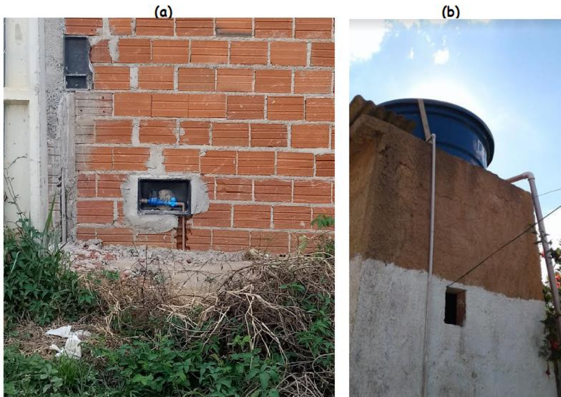
Figura 12 - Abastecimento de água Rede Embasa. (a) contador no loteamento parque Conveima (b) Caixa d'água em pé de galinha
