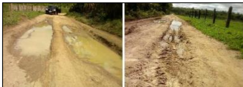
Figura 44 – Estrada de acesso para Quatis dos Fernandes, em 16/11/2018
